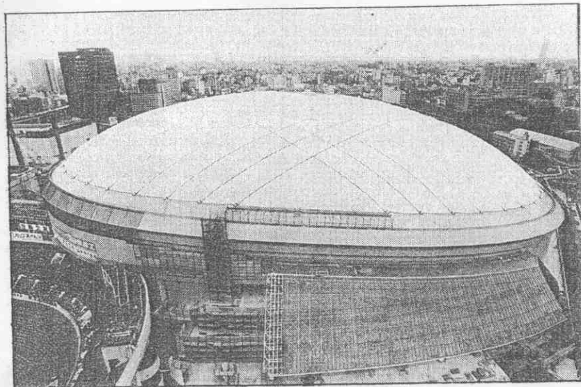
←這是位於日本東京後樂園的「巨蛋」體育館，幾年後高雄也將擁有一座如此體育館。(本報資料照片)
